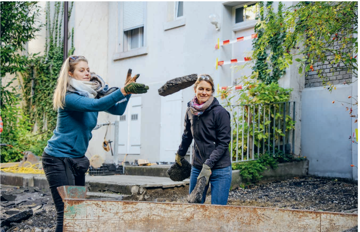
Der aufgebrochene Asphalt wird abtransportiert und fachgerecht entsorgt. Les plaques de goudron sont évacuées et éliminées dans les règles de l'art.
